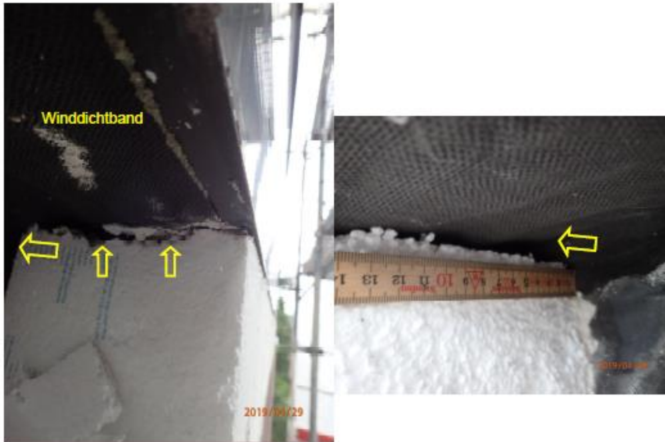
Foto 10 Die Anschlüsse der Wärmedämmung sind nicht satt an das Fensterrahmenprofil angeschlossen.
